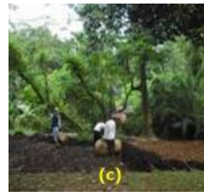
Gambar 3. (a) kegiatan pematokan dan pengukuran, (b) pembersihan tapak, dan (c) kegiatan grading tanah.
